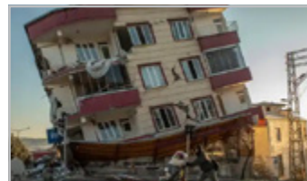
ساختمان آسیب دیده در قهرمان ماراش بر اثر ایجاد طبقه نرم
